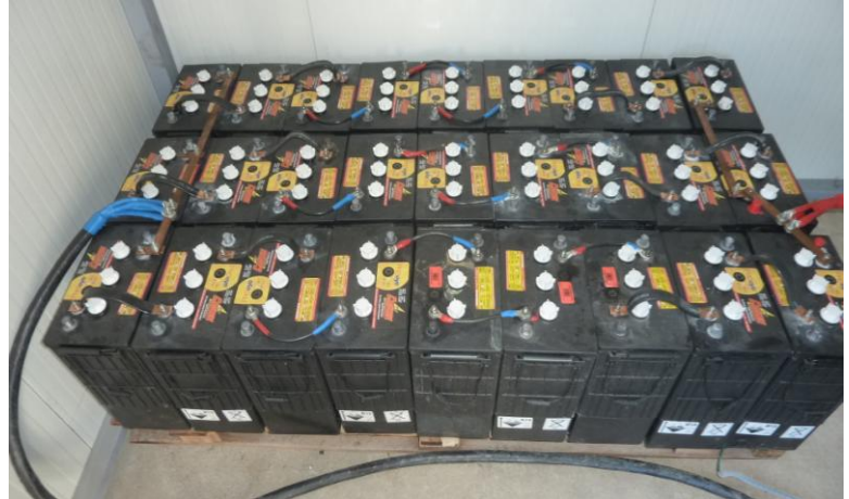
Sistemul de stocare a energiei electrice
